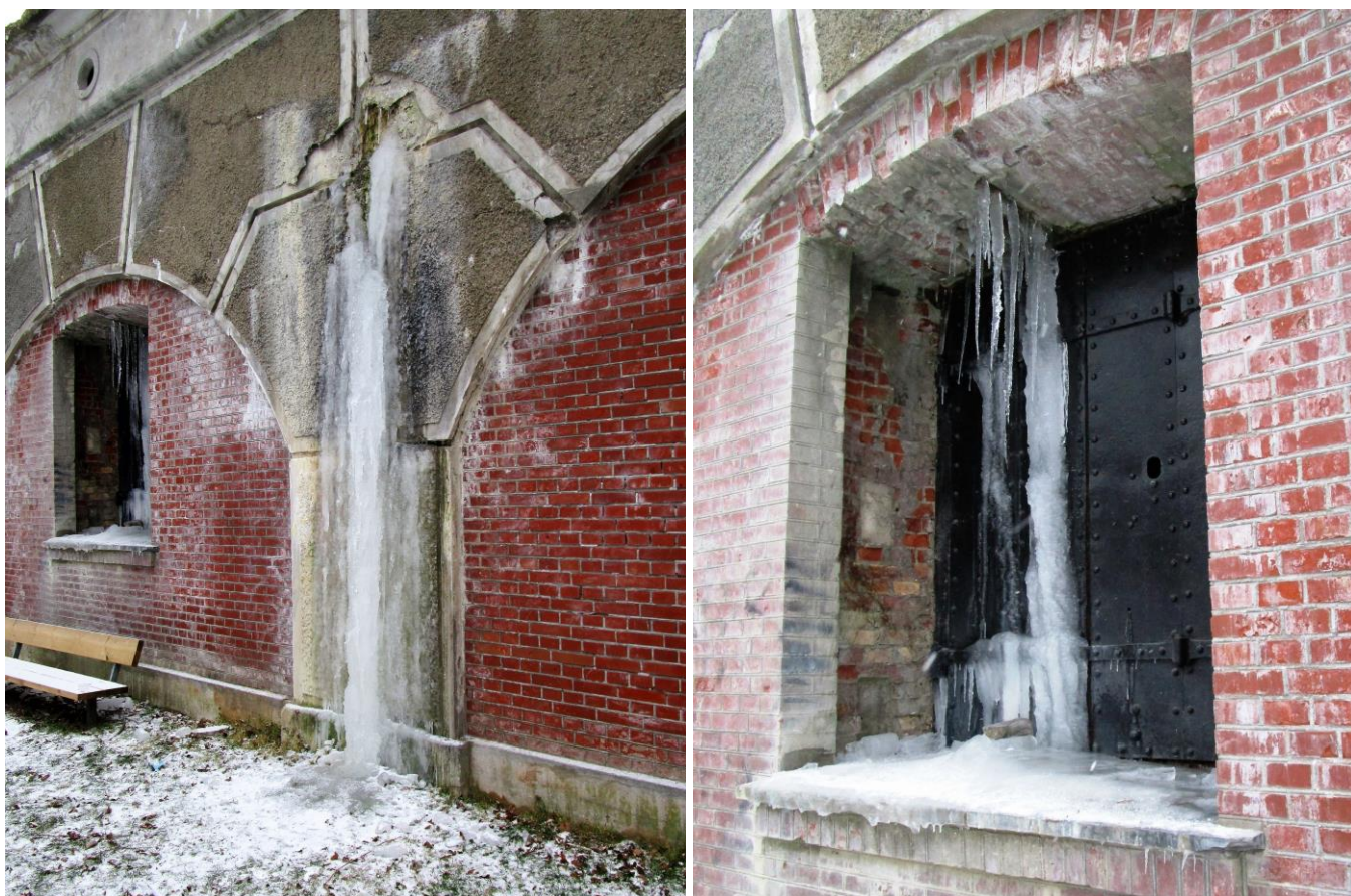
Lyngbyfortet 6. januar 2016. Murværket ødelægges af is, fordi tagrende ikke vedligeholdes
